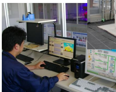
←管理棟の制御コンピューター
