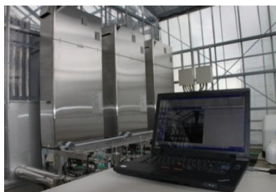
地中熱ヒートポンプ
