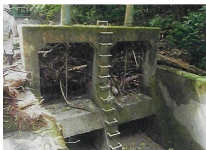
ふ化場の取水施設（深浦町）
