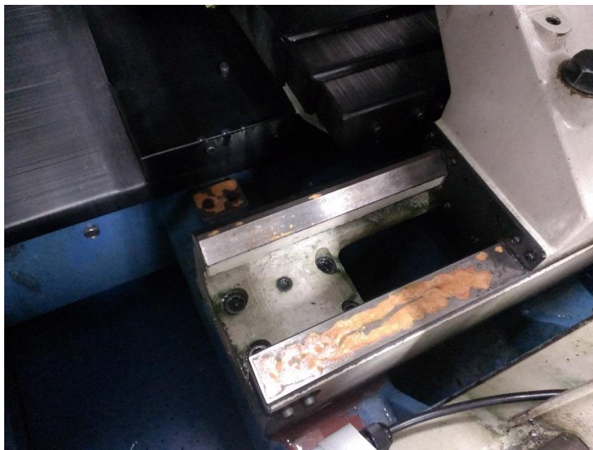
図 1 アルカリ性電解水を用いた加工後 NC 旋盤内に発生した錆
