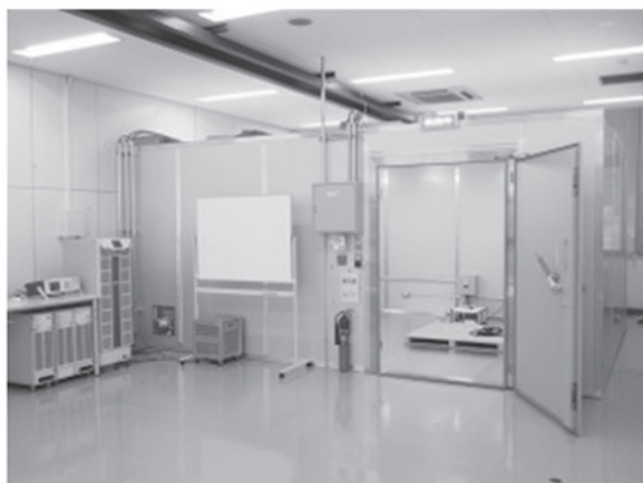
導入したサージ試験用シールドルーム
