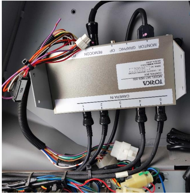
図 2 0 カメラ搭載クレーン車の映像出力端子の確認
