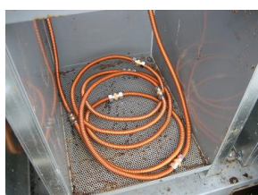
(b) 銅製フレキシブルパイプ (改良版)
