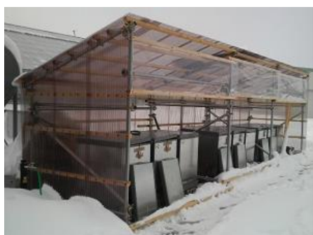
堆肥発酵熱回収コンテナと新たに設置した防雪用小屋
