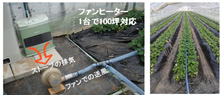
写真1 ファンヒーターでのCO 2 施用方法
