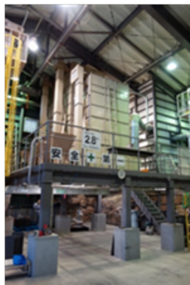
乾燥・調製施設に設置されている専用の大型乾燥機
